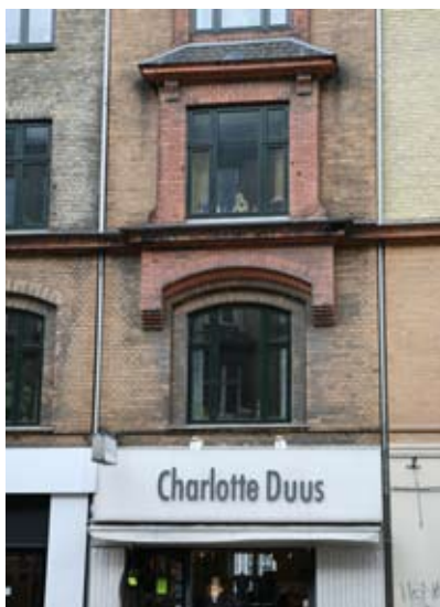
Tilsodet facade i blankmur, Gammel Kongevej, Frederiksberg.
