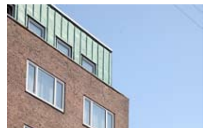
Overgangen mellem penthouse og facademurværk fremstår skarp.
